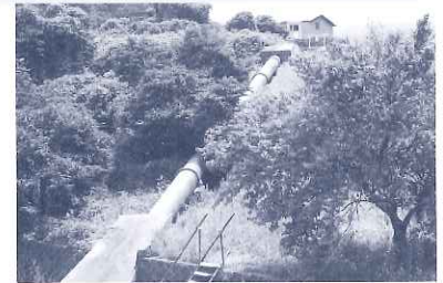
山一産業 小水力発電所
