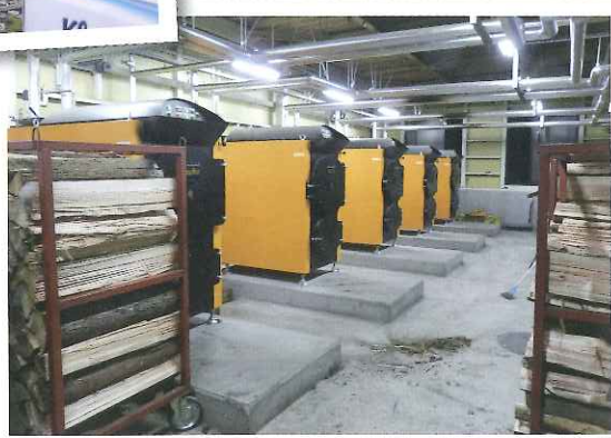
「道志の湯」木材ボイラー
