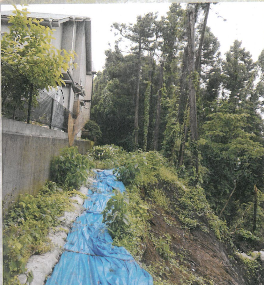
森林崩壊の現場
