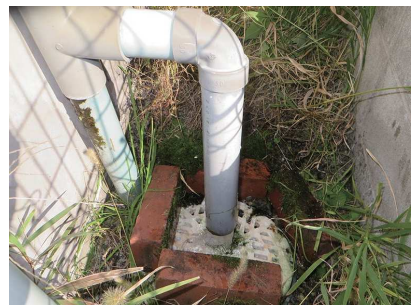
【建屋の外に引かれた自噴水】
